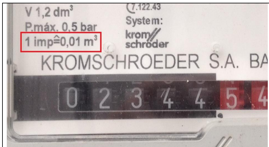
Fig.2.Relación de impulsos del contador de Gas
